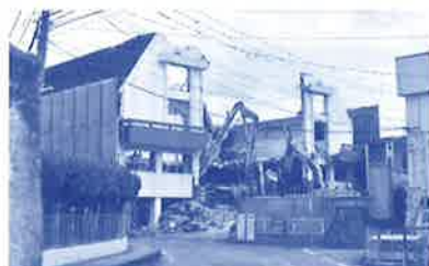
敷地に囲いが張られ、クレーンが登場、放水 しながら解体作業が進みます(R1.8月)
